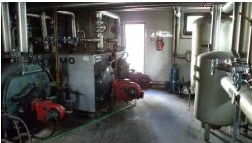
Fotografija 3: Prikaz postavitve ogrevalnih naprav v kotlovnici.
